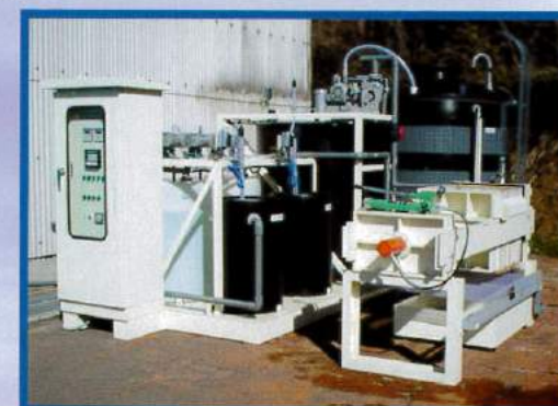
ユニット型バレル排水処理装置 (処理流量1m³/Hr)
